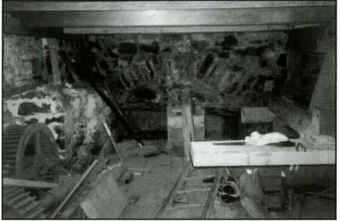
Fig. 27. Le moulin Légaré, Saint-Eustache, Qc. Arc de décharge au-dessus de la prise d'eau, mur ouest du moulin. (Jean Bélisle, Maître d'œuvre de l'histoire, 1-14, 1999)
