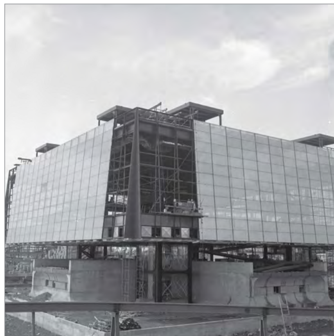
ILL. 13. PROGRESSION DES TRAVAUX, PAVILLON DU QUÉBEC. | GABOR SZILASI ET ADRIEN HUBERT, 1966. BIBLIOTHÈQUE ET ARCHIVES NATIONALES DU QUÉBEC, CENTRE D'ARCHIVES DE MONTRÉAL, SÉRIE OFFICE DU FILM DU QUÉBEC, E6, S7, S51, P661619.
